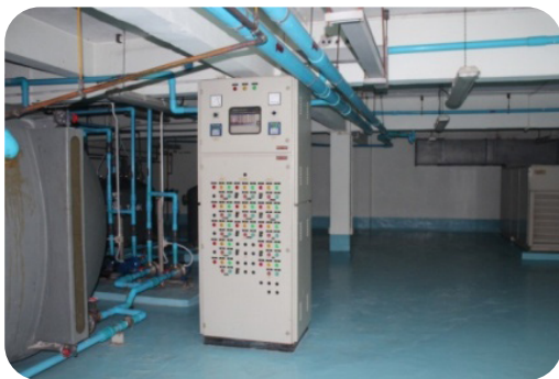
รูปที่ 13.3 ตู้ควบคุมระบบบำบัดน้ำเสีย
