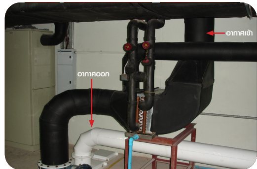
รูปที่ 4.2 อากาศที่ผ่านการทำความเย็นผ่านท่อที่หุ้มฉนวนสีดำง่ายเข้า BSL-3
