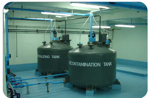
รูปที่ 13.4 ถังบำบัดเชื้อ และ ถังปรับค่ากรด-ด่าง
