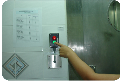
รูปที่ 9.2 กดปุ่มเปิดประตูจากห้อง secure zone แล้วเข้าไปใน air lock shower room
