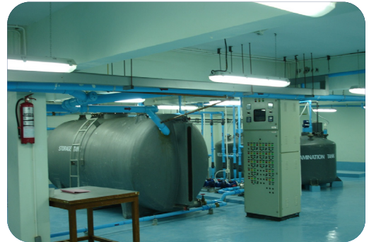
รูปที่ 13.2 ถังกักเก็บน้ำเสีย
