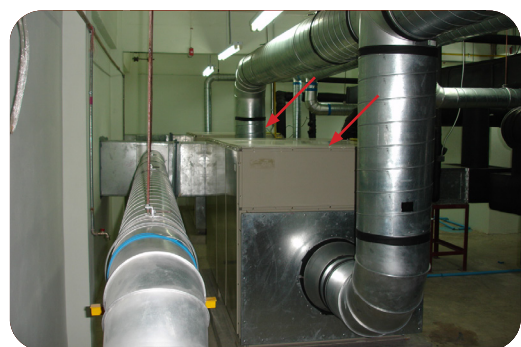
รูปที่ 4.4 Exhaust fan 2 ตัว ดึงอากาศออก ทำงาน สลับกัน กรณีที่อีกตัวต้องซ่อมบำรุงหรือเสียหาย
