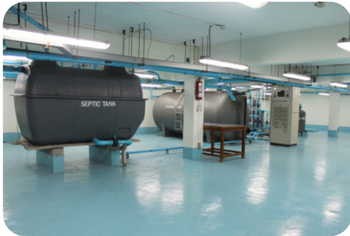
รูปที่ 13.1 ถังน้ำเสีย
