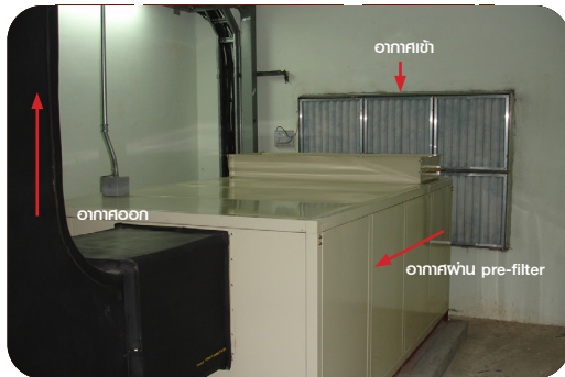
รูปที่ 4.1 อากาศจากภายนอกอาคารผ่าน pre-filter
