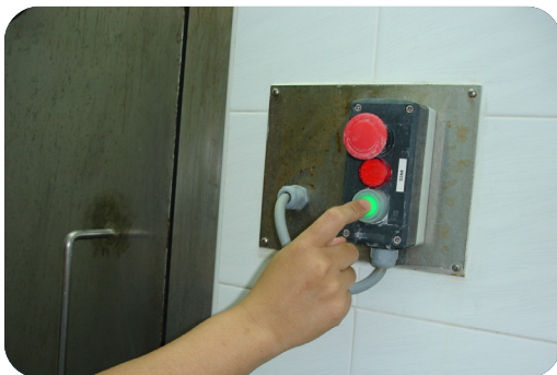
รูปที่ 8.3 กดปุ่มเปิดประตูจากใน air lock shower room แล้วเข้าไปด้าน secure zone
