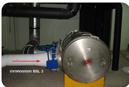
รูปที่ 4.3 อากาศจาก BSL-3 ผ่านท่อสีขาวที่ปิดสนิทไปกรองที่ HEPA canister
